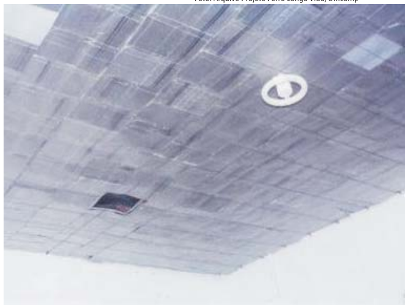
Com o forro feito de caixinhas longa vida, habitações cobertas com telhas de cimento-amianto ganham conforto térmico
