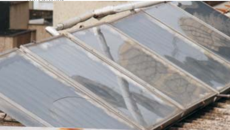
Painéis de energia solar para aquecimento de água instalados em edifício
